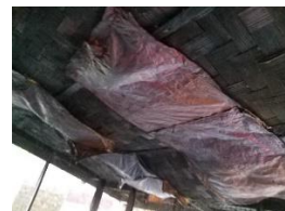
Beschädigte Decke der Küche
